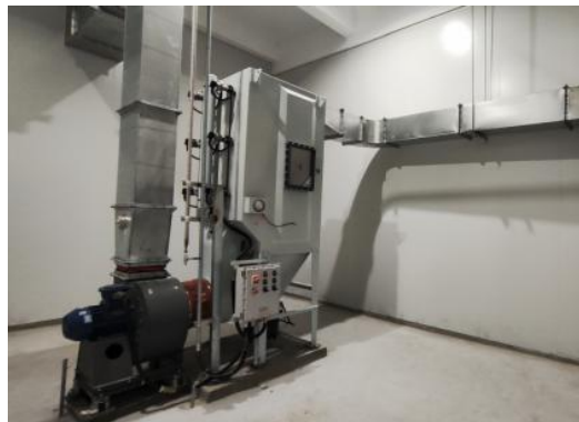
806 车间布袋除尘器现场照片
