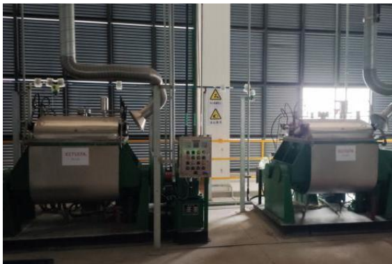
806 车间捏合机粉尘收集措施
