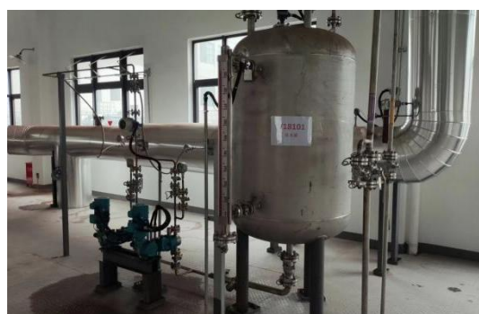
SCR 脱硝系统氨水储罐
