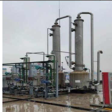
二级填料吸收塔
